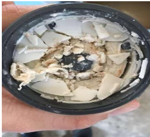
الشكل رقم (12): تلف الأنابيب نتيجة استخدام الغاز
